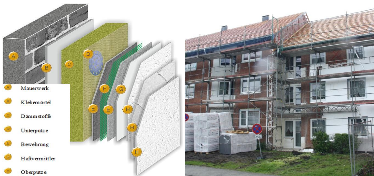
Abbildung 6-19: schematischer Aufbau eines Wärmedämmverbundsystems (links, Quelle: K & G Putz- und Farbenhandel GmbH, 2012), Anbringung von WDVS in Flensburg (rechts, eigenes Foto)
